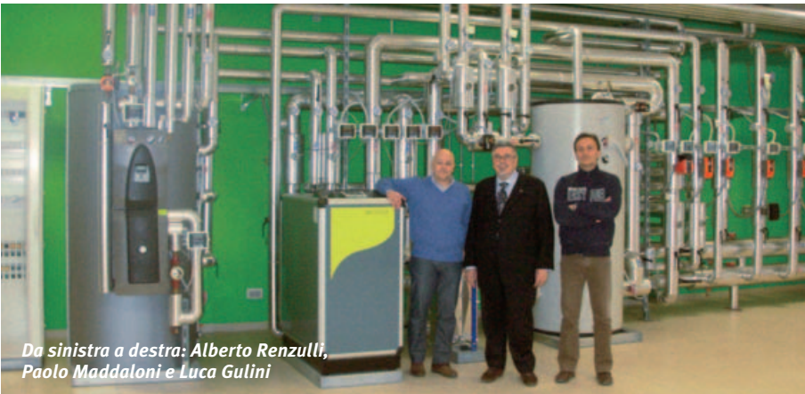
Locale centrale termica
